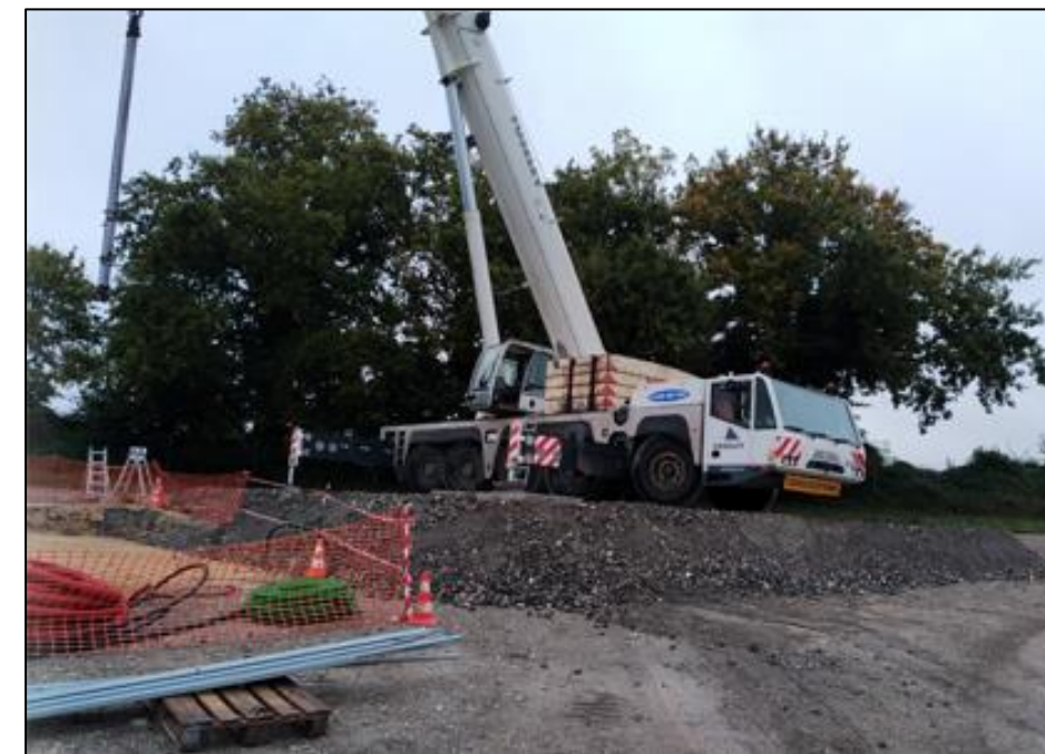
Figure 240 : Illustration du type de grue utilisée pour la pose des postes électrique (source : Valeco)
